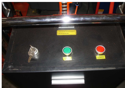
Poste de commande extrêmement simple
